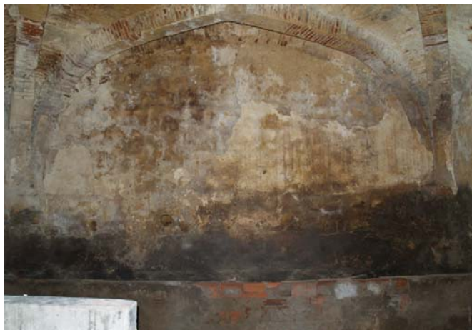
Manchas em revestimentos do piso 0 (nitratos e humidades)
