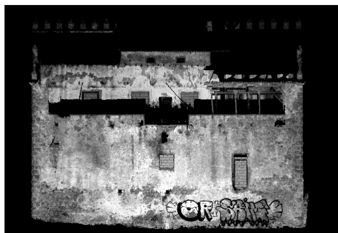
Análise da deformação do plano da fachada sul
