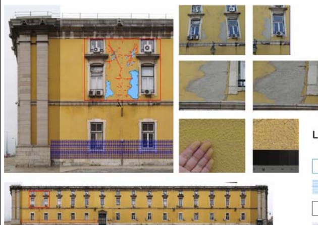
CE - Ala nascente (Alçado nascente) - Ilustração das formas de degradação das pinturas e rebocos
