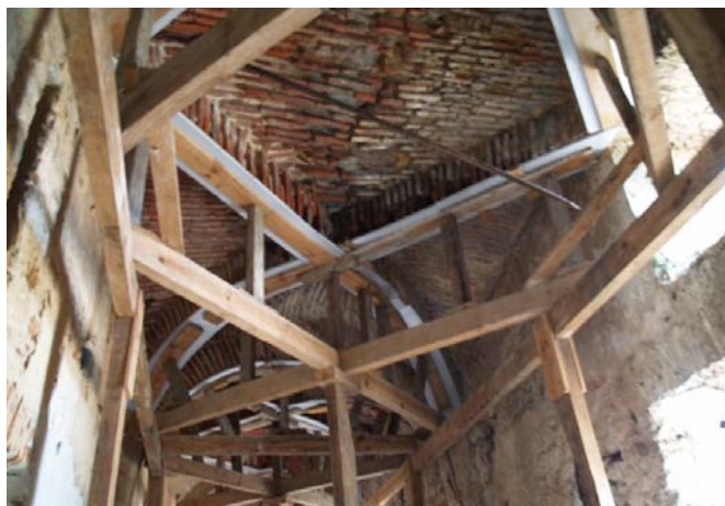
Escoramento das abóbadas sob a loggia (tirantes não funcionais e fissuração)
