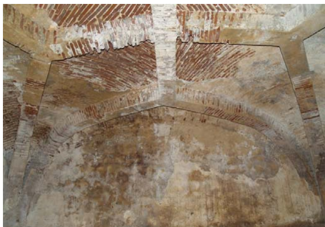
Abóbada do terço central do piso 0 (ausência de revestimentos e manchas)
